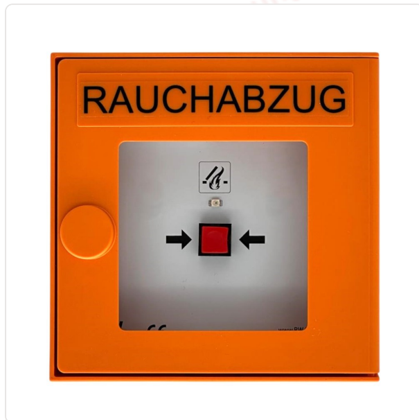
Beispiel: Bedien-/Auslösestelle einer Rauch- und Wärmeabzugsanlage.
